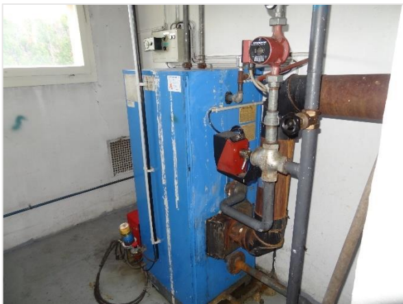
Chaudière à mazout
