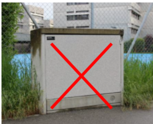
(e) Armoire électrique.
