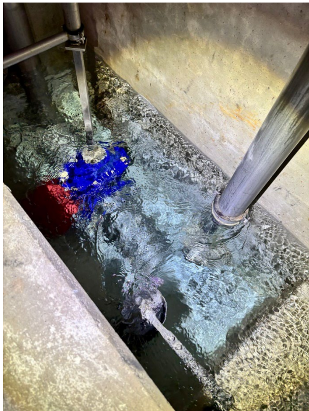
Photo 3 – Vue de l'écrêtage de crue et du départ de l'eau dans le réseau.
