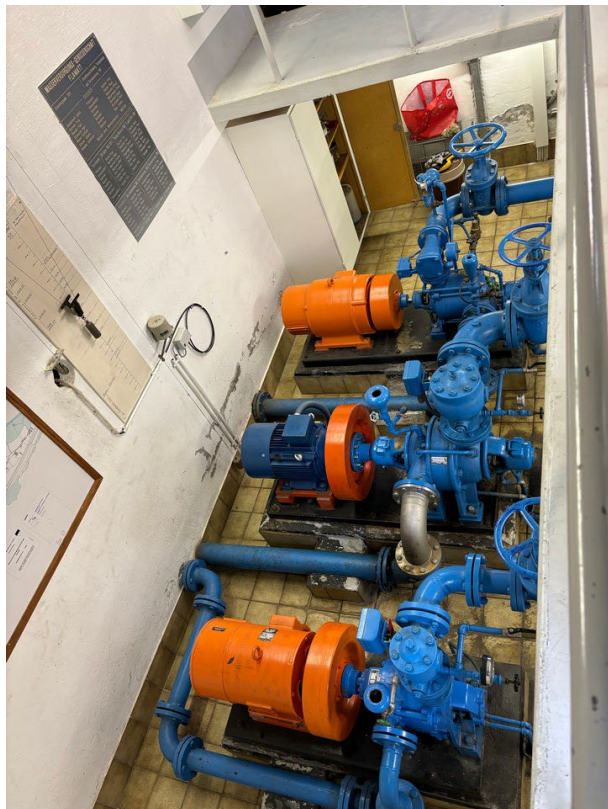
Photo 3 – Salle des pompes.
