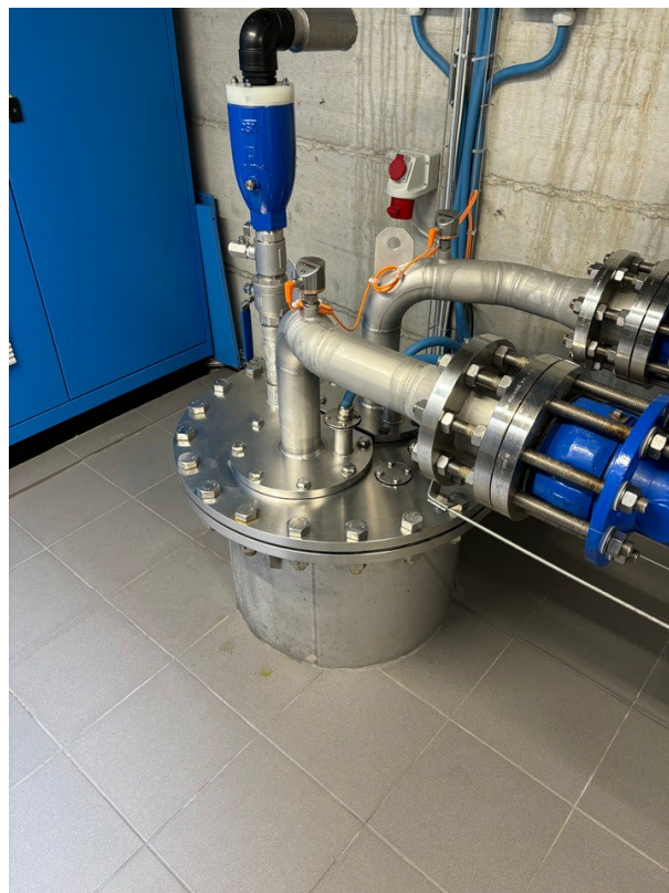
Photo 2 – Vue du puits avec les deux pompes.
