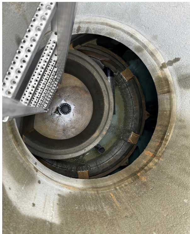
Photo 2 – Vue du captage et de l'arrivée des 3 drains.
