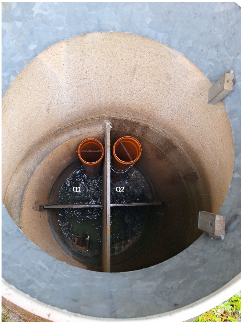
Photo 2 – Chambre de régulation (ou de réunion), juste entre les captage Q1-Q4 et le réservoir des Frassettes
