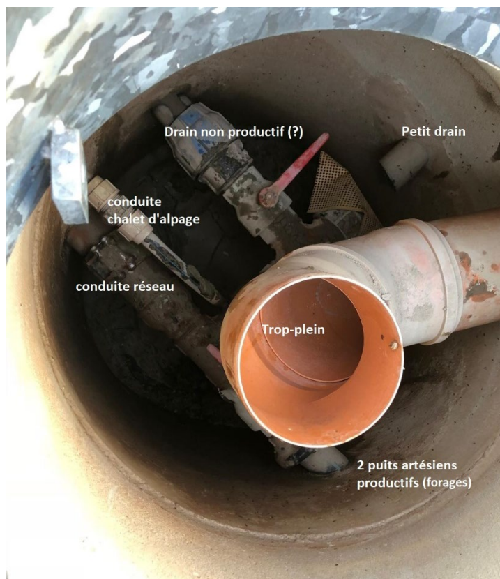
Photo 2 – Intérieur de la chambre de captage.
