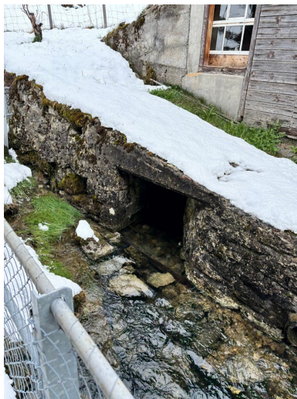
Photo 2 – Résurgence de la source sous le bâtiment.
