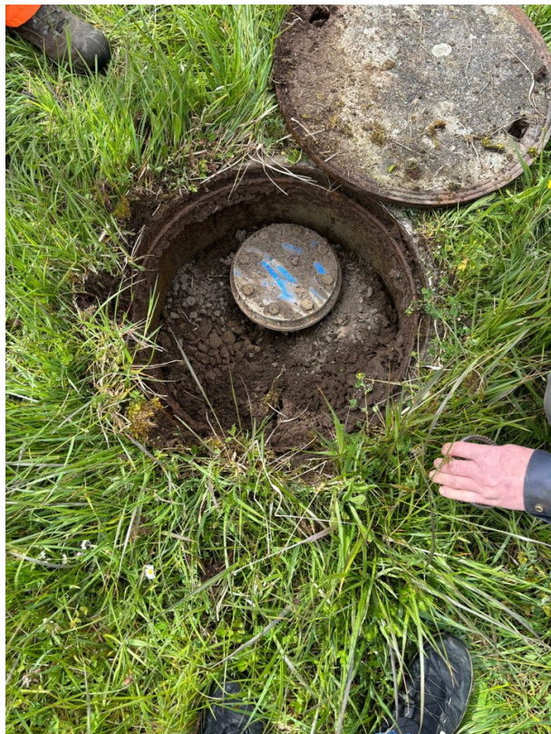
Photo 3 – Piézomètre F2 boulonné se trouvant sous un couvercle béton.
