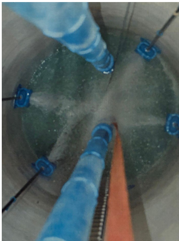
Figure 3 – Arrivée des drains horizontaux dans le puits.
