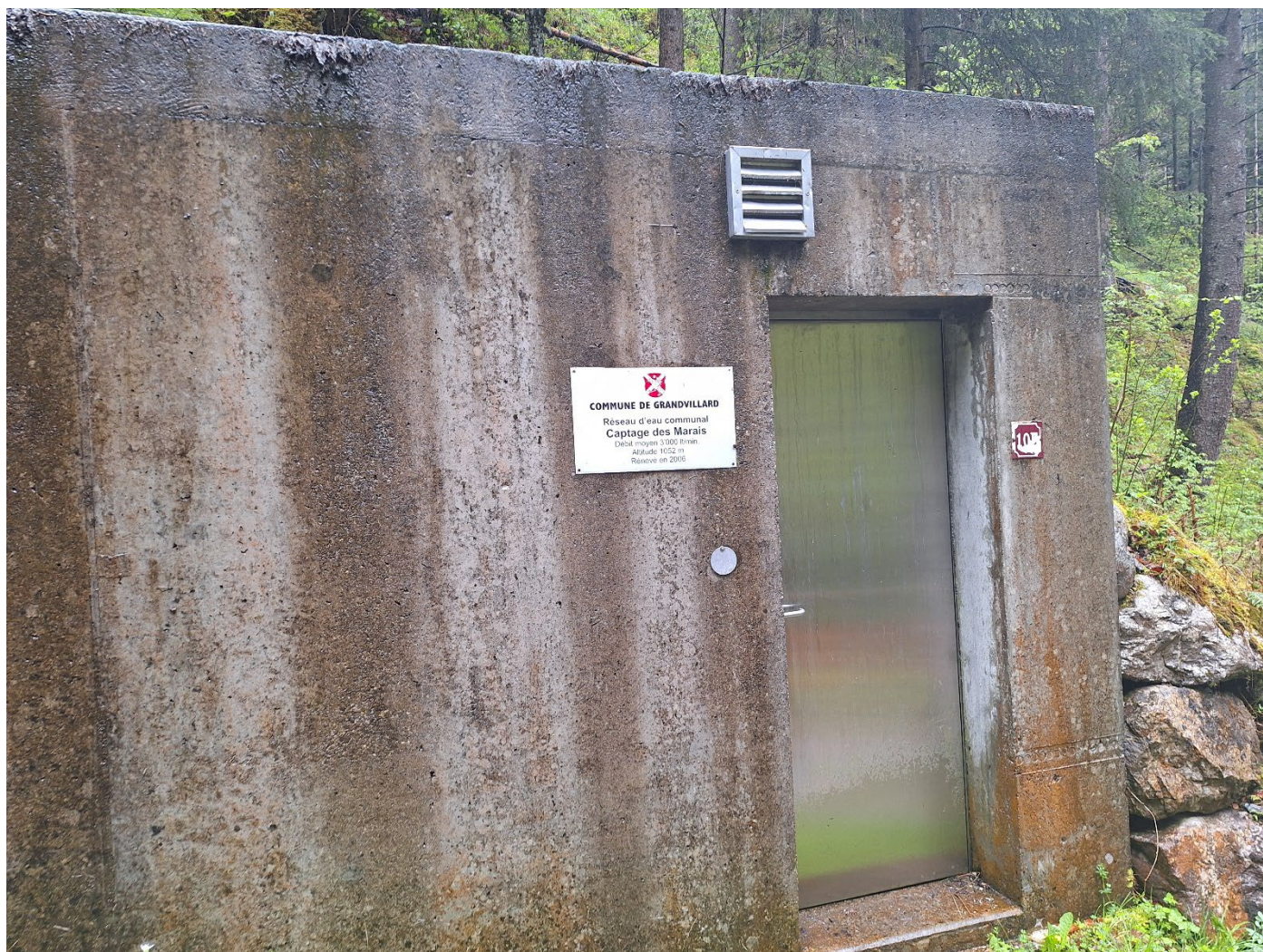
Photo 2 – Réservoir de mise en charge, juste en aval de la source.
