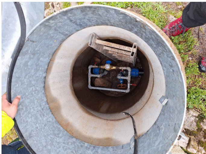
Photo 3 – Chambre avec compteur de débit.
