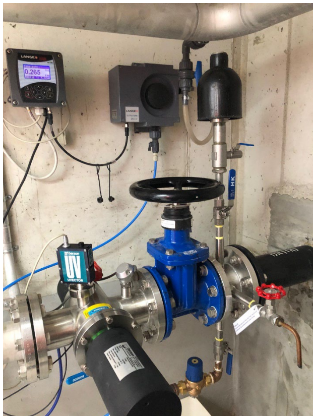
Photo 2 : Chambre de traitement UV de Praz
