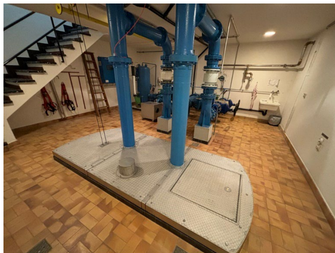
Figure 2 – Chambre de captage.
