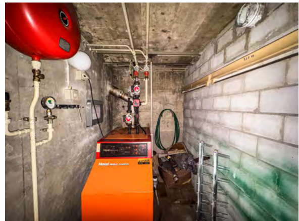
Local technique, chaudière à mazout
