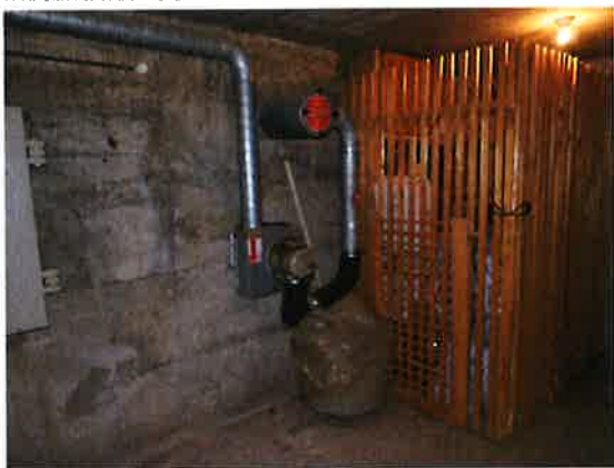
Installation de ventilation de l'abri PC
