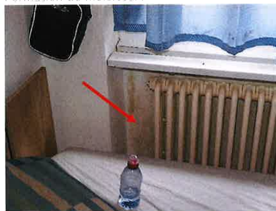
Formation de moisissure
