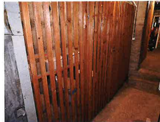
Installation sanitaire de l'abri PC
