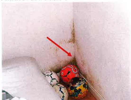
Formation de moisissure
