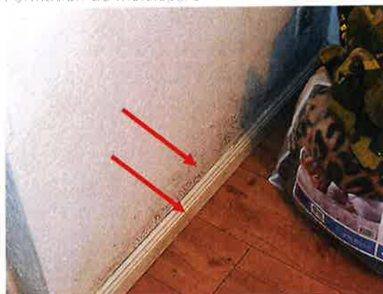
Formation de moisissure
