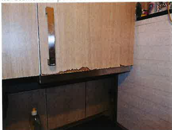
Revêtement de porte usé
