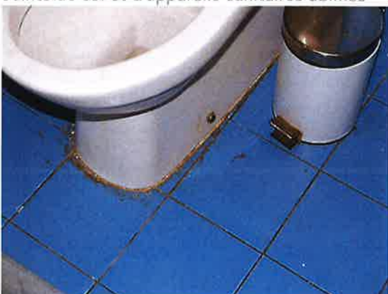
Joints de sol et d'appareils sanitaires abîmés
