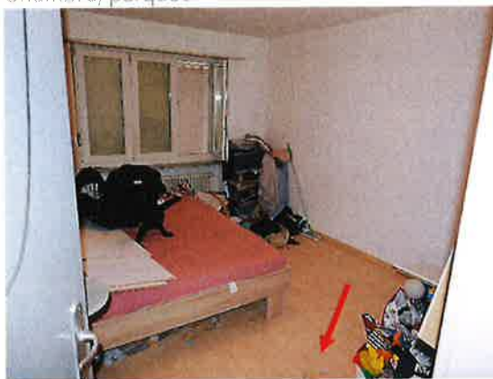
Chambre, parquet flottant abîmé
