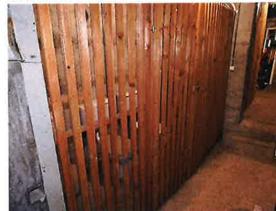
Installation sanitaire de l'abri PC
