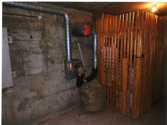
Installation de ventilation de l'abri PC
