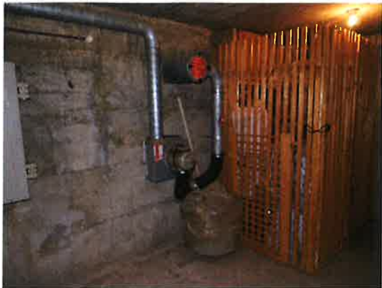
Installation de ventilation de l'abri PC
