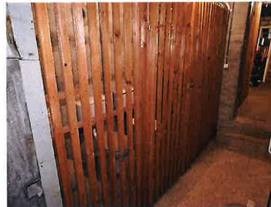
Installation sanitaire de l'abri PC
