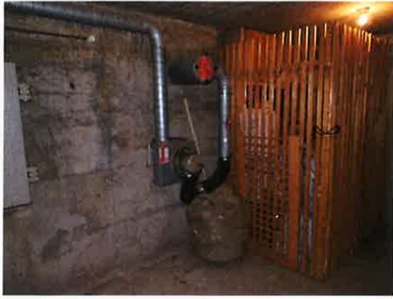
Installation de ventilation de l'abri PC
