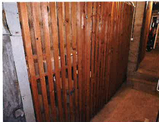
Installation sanitaire de l'abri PC
