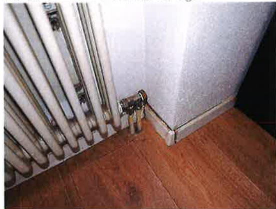
Ancienne fuite d'eau de chauffage
