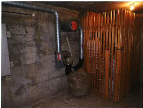
Installation de ventilation de l'abri PC
