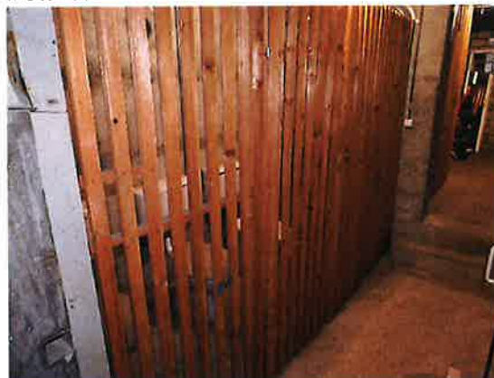
Installation sanitaire de l'abri PC
