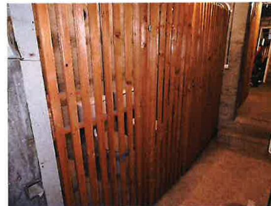
Installation sanitaire de l'abri PC
