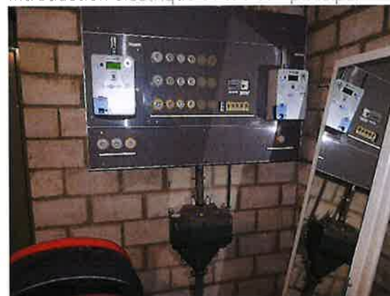
Introduction électrique et tableau principal
