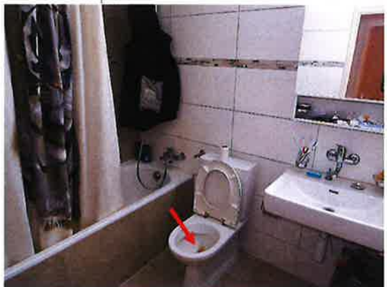
Présence importante de calcaire dans la cuvette
