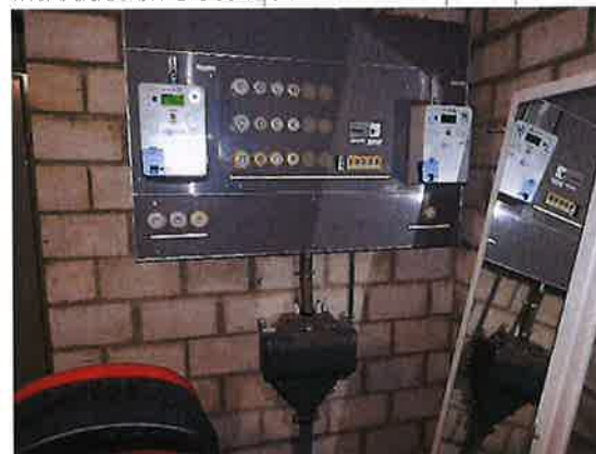
Introduction électrique et tableau principal
