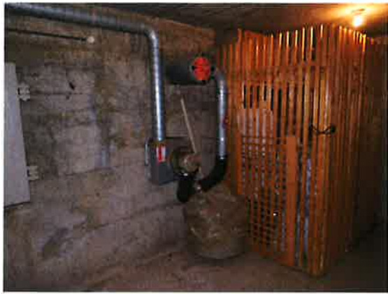
Installation de ventilation de l'abri PC
