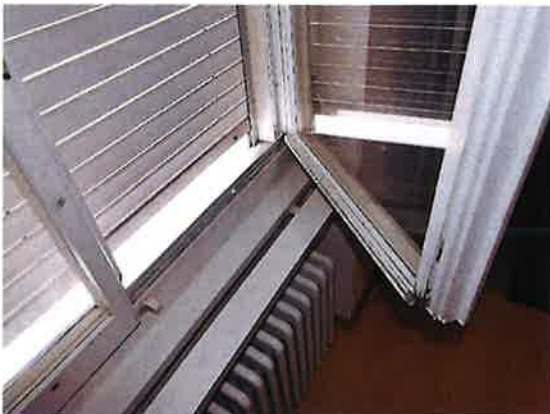
Fenêtre en bois en fin de vie
