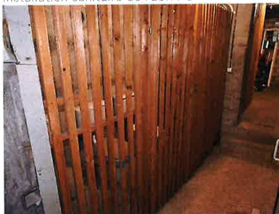
Installation sanitaire de l'abri PC
