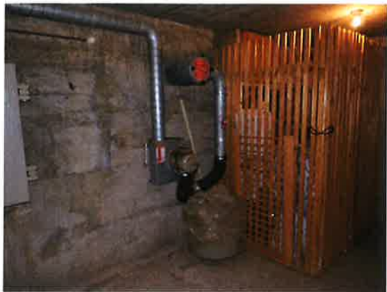
Installation de ventilation de l'abri PC
