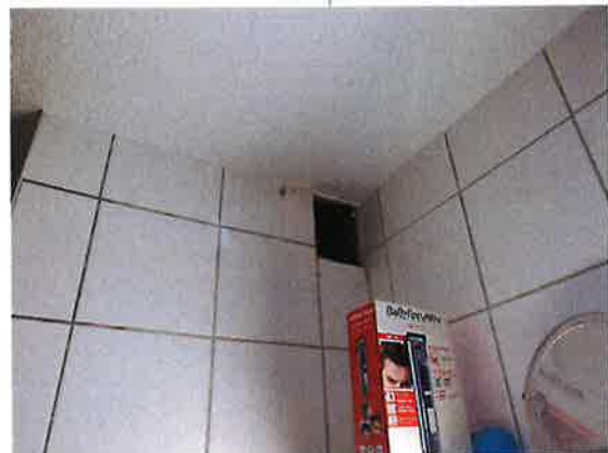
Grille de ventilation manquante
