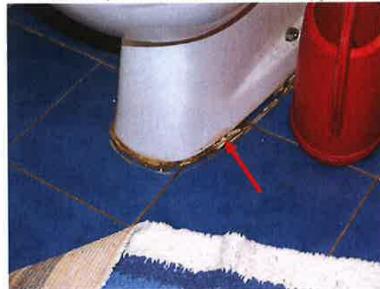
WC descellé, écoulement nauséabond, joint cassé
