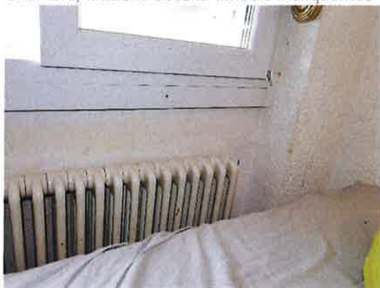
Chambre, finitions sous la fenêtre manquantes
