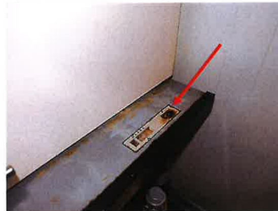
Hotte de ventilation défectueuse
