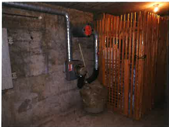
Installation de ventilation de l'abri PC
