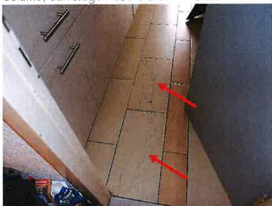
Cuisine, carrelage fissuré à divers endroits
