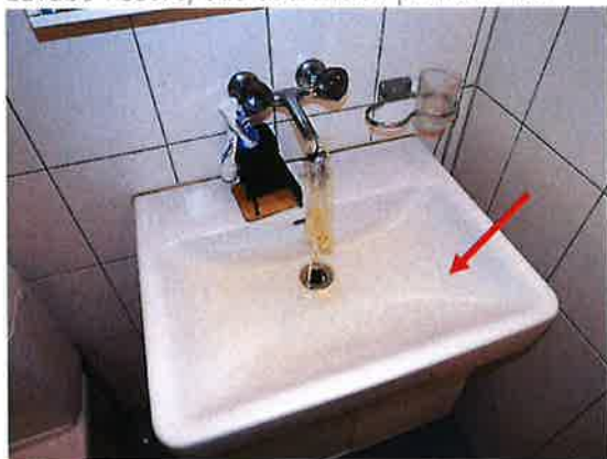
Lavabo fissuré, eau coulant en permanence
