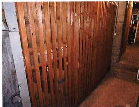
Installation sanitaire de l'abri PC
