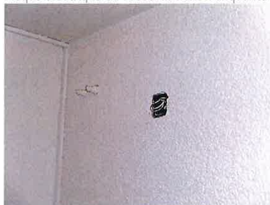
Plaque électrique de recouvrement manquante
