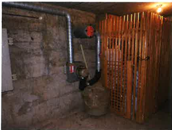
Installation de ventilation de l'abri PC
