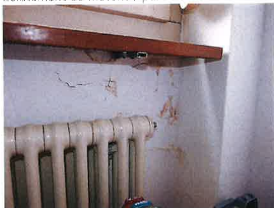
Eclatement du matériau par infiltration d'eau
