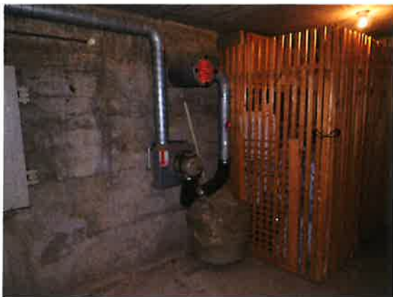
Installation de ventilation de l'abri PC
