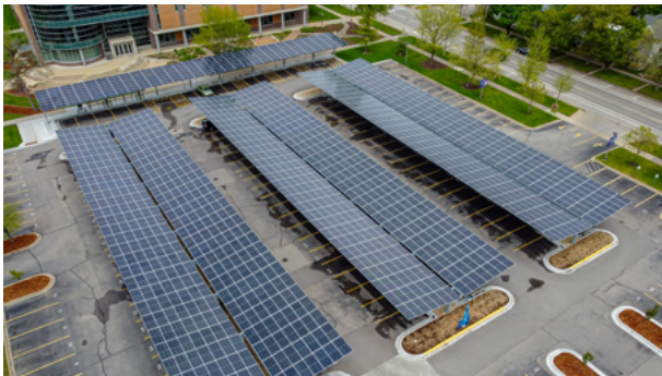
Carport photovoltaïque, photo libre de droit
