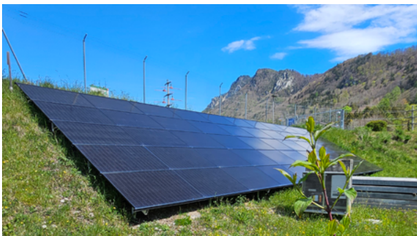
Centrale photovoltaïque de Payerne, © NET Nowak Energie & Technologie SA
