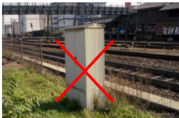
(f) Armoire de télécommunication.
