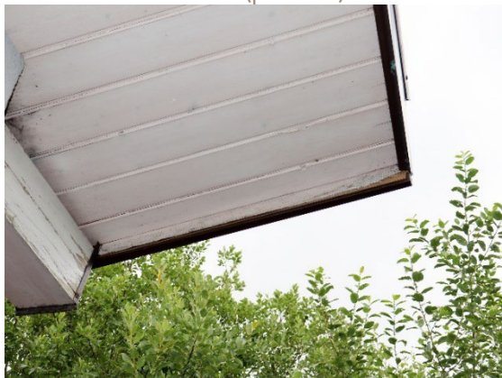
Avant toit à entretenir (peinture)
