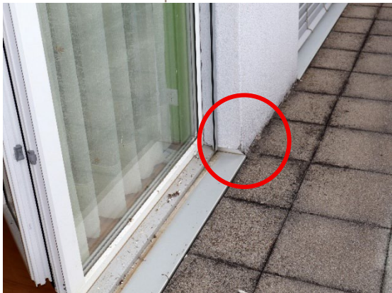
Fissures dans le crépis
