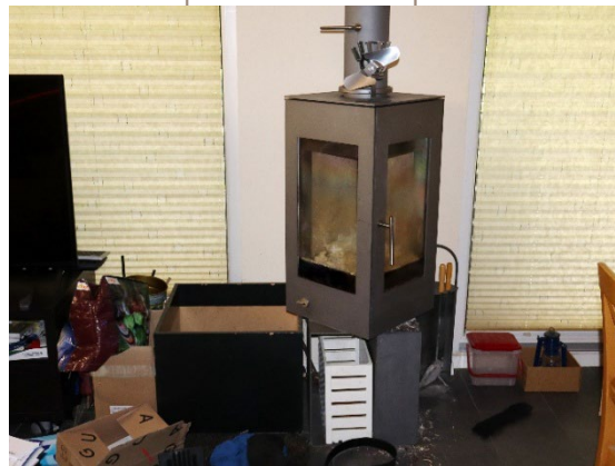
Poêle métallique au centre des pièces
