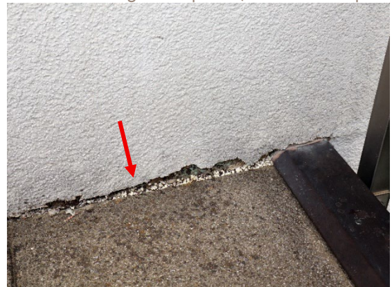
Bande de serrage manquante, finition inadaptée
