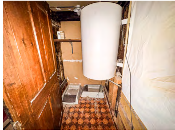
local avec boiler
