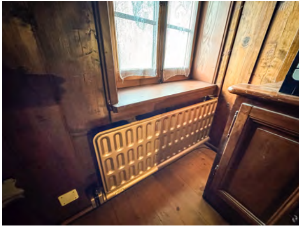
Radiateur dans le hall
