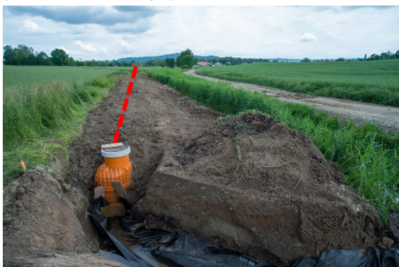
Fig. 27c : Regard du système collecteur courant parallèlement au cours d'eau (ligne en traitillé). (photo : Christof Angst)
