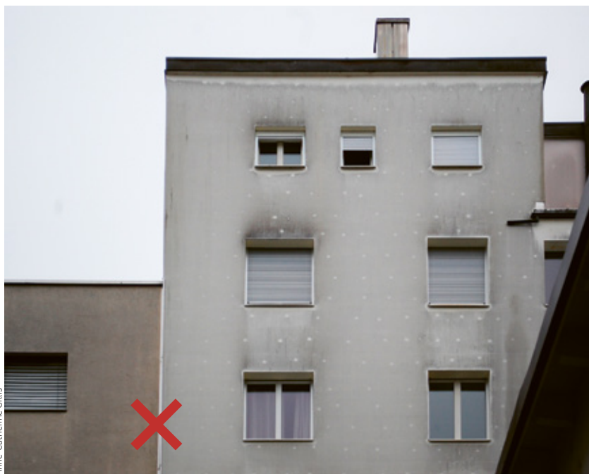
Un exemple parmi d'autres de l'enlaidissement de notre environnement urbain suite à la pose d'une isolation extérieure synthétique. Ici sur Pérolles en ville de Fribourg.
