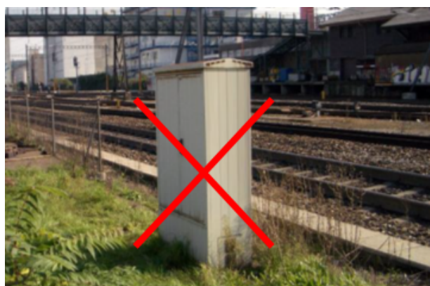
(f) Armoire de télécommunication.
