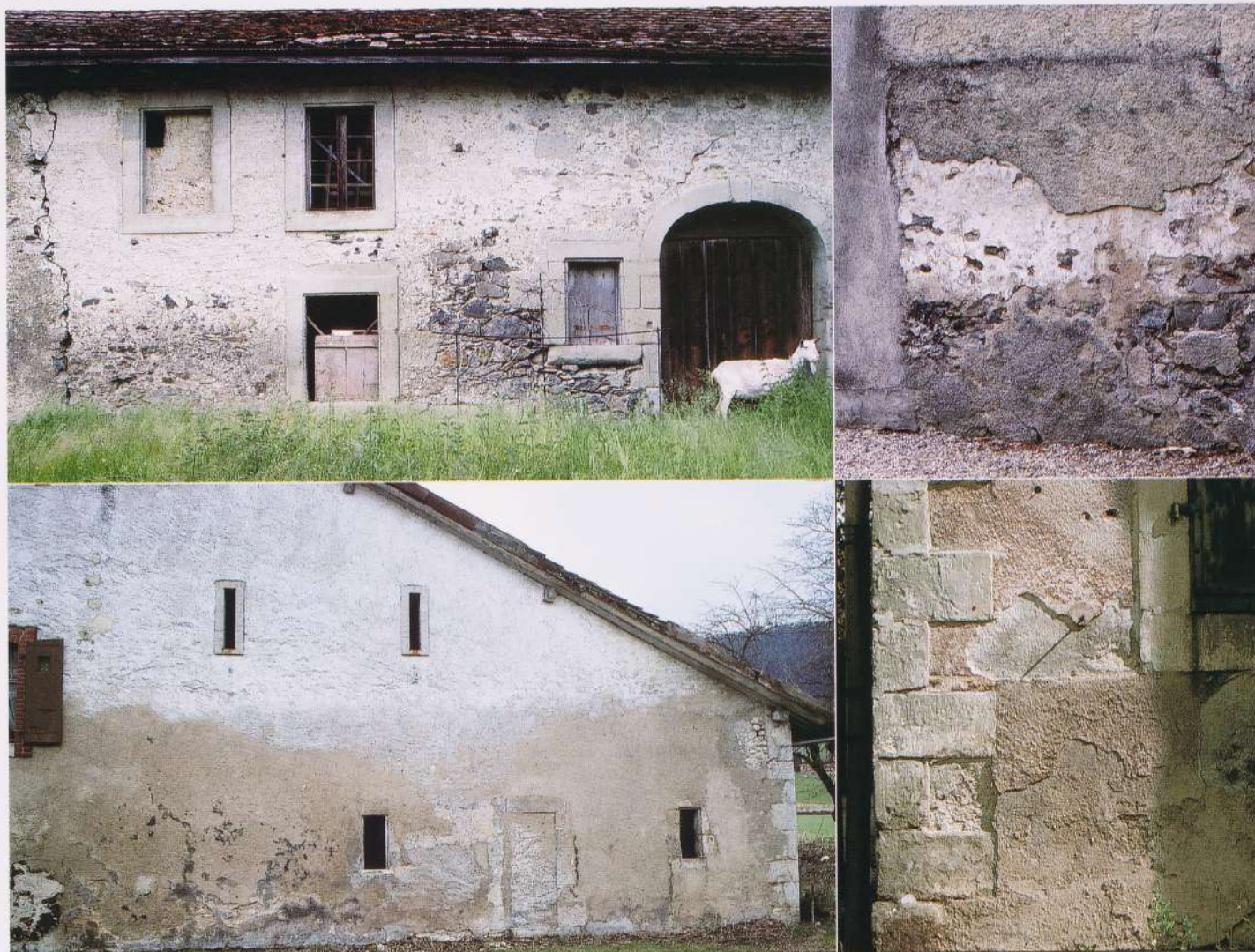
Exemples d'altérations provoquées par l'humidité et les sels.
