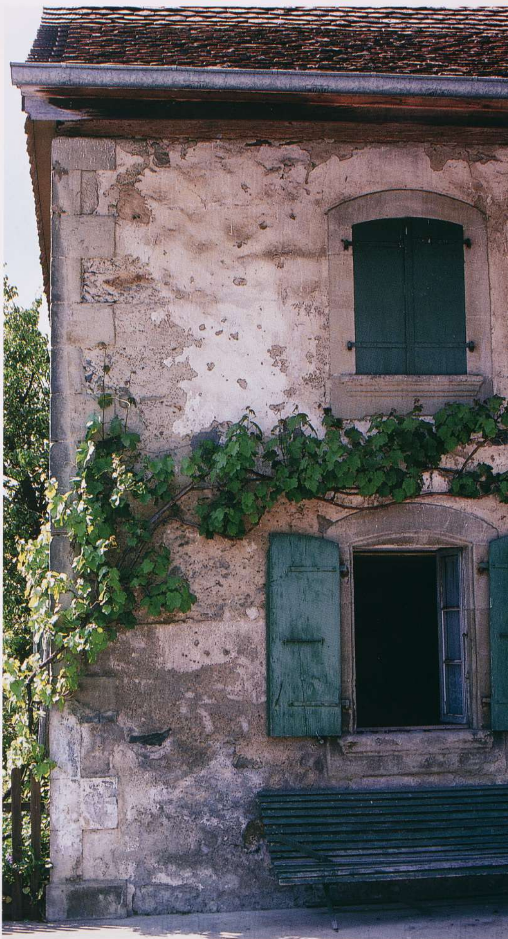
Façade d'une maison villageoise du XVIII e siècle avec de larges plages conservées de son crépi d'origine.
