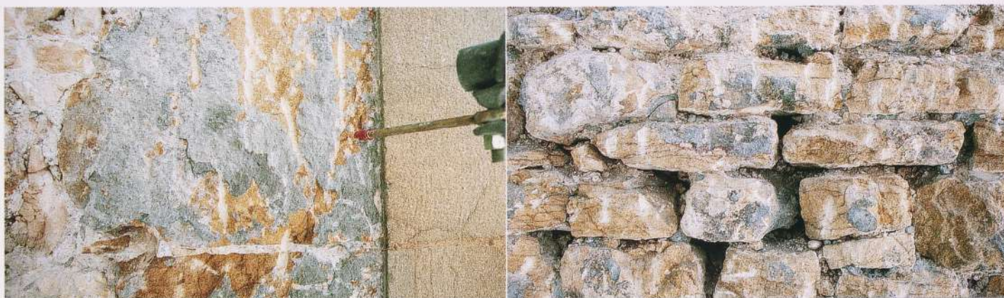
Dégâts infligés au parement lors de l'élimination d'un crépi trop dur.
