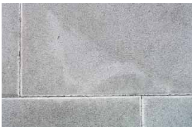
Illustration 16: Endommagement des dalles dû à l'absence de joints
