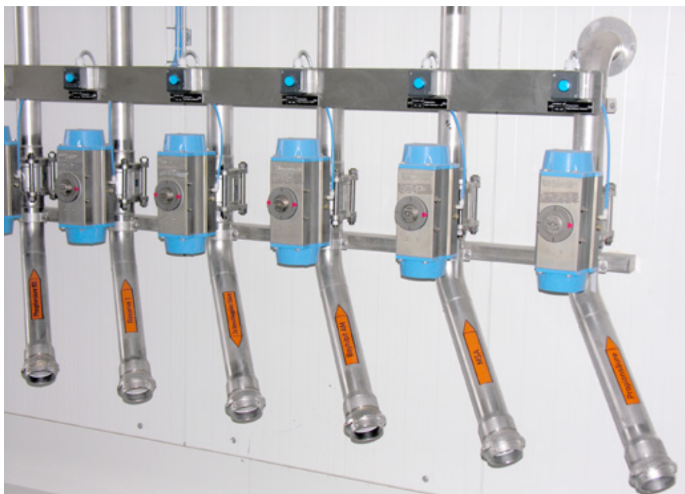
Figure 6 Poste de remplissage de citernes fixes (Entreprise Halag, canton de Thurgovie)
