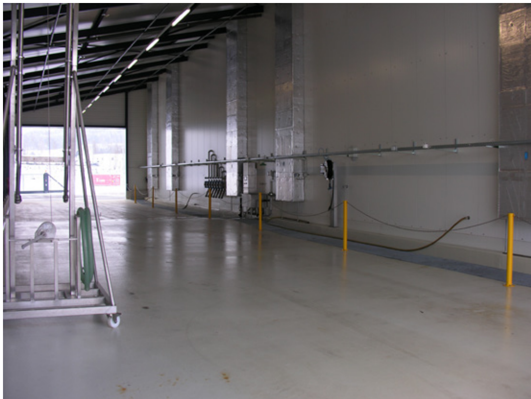
Place de transbordement pour camions-citernes avec revêtement résistant et bassin de rétention, Halag Chemie AG, Aadorf
