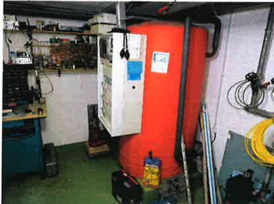
Pompe à chaleur et stock tampon
