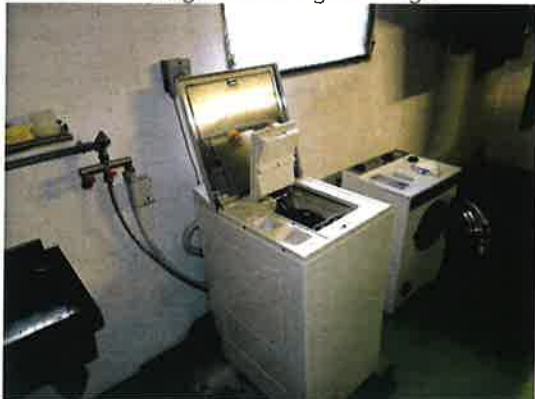
Installation lavage et séchage du linge
