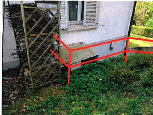
Absence de garde-corps
