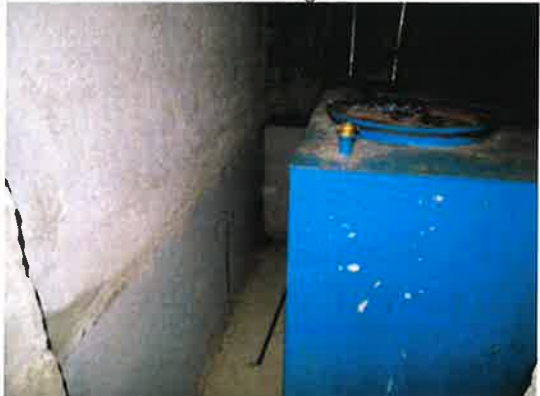
Local citerne et son cuvelage étanche
