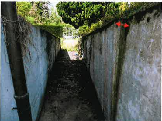
Chemin d'accès, tassement différentiel du mur
