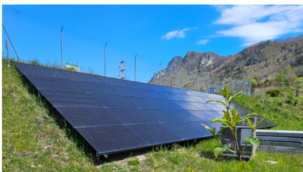
Photovoltaikanlage Electrobroc, © NET Nowak Energie & Technologie SA
