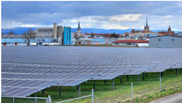
Photovoltaikanlage in Payerne, © NET Nowak Energie & Technologie SA
