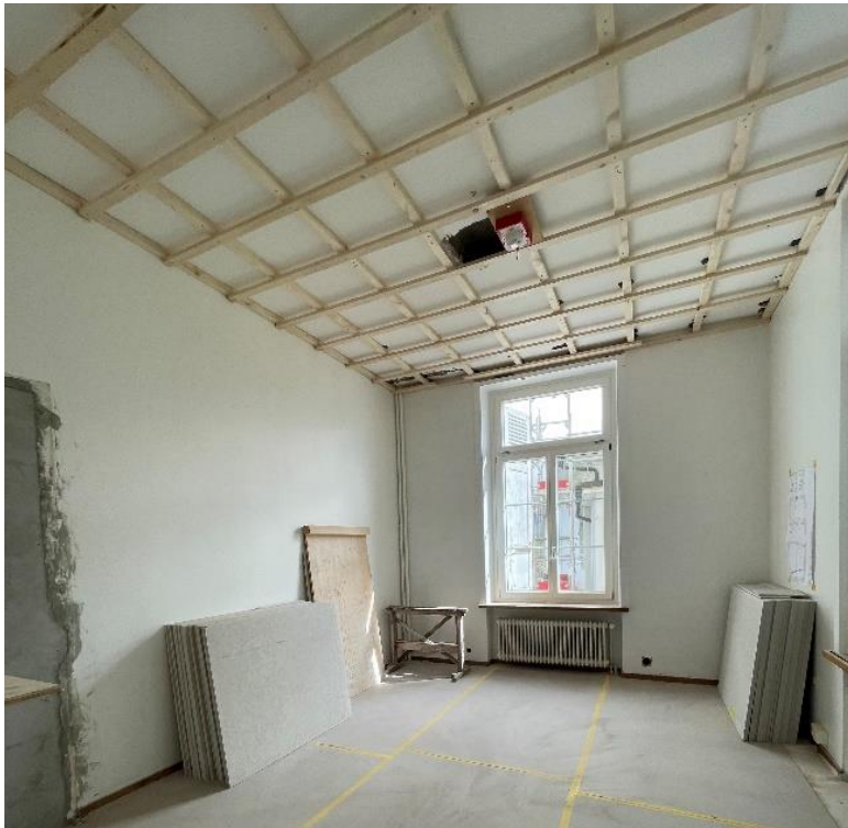
Photo n° 5: Reprise sols et plafonds nécessaire
