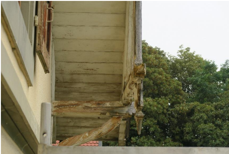
Foto Nr. 1: Beschädigte Traggerippe
