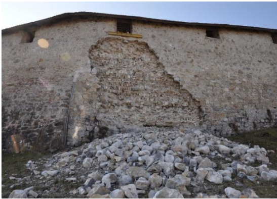
Figure 3 Mur Nord - Dégât du 6 mars 2012
