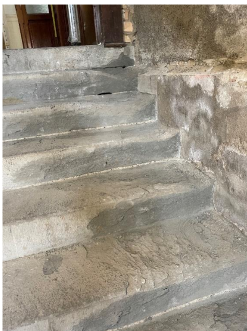
Photo n°3: escalier intérieur en molasse altéré 1
