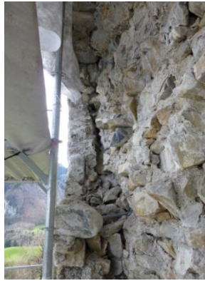
Abb. 2 Nördlicher Teil der Mauer – Ablösen des Sichtmauerwerk
