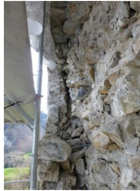
Figure 2 Mur Nord - Décollement du parement
