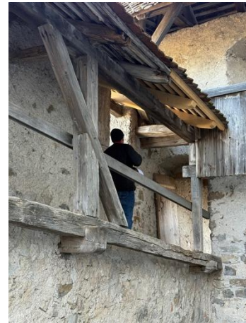
Abb. 4 Wehrgang – Notreparatur am Dachstuhl
