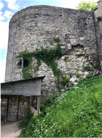
Figure 6 Tour ronde - Dégât du 6 mars 2012
