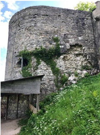
Abb. 6 Rundturm – Schäden vom 6. März 2012
