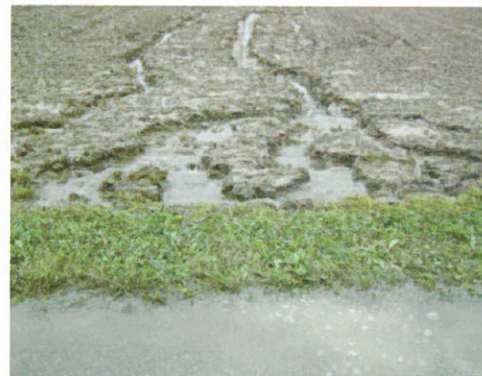
Erosionsrinnen durch Wasserzufluss von einer Strasse.
