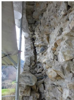
Abb. 2 Nördlicher Teil der Mauer – Ablösen des Sichtmauerwerk
