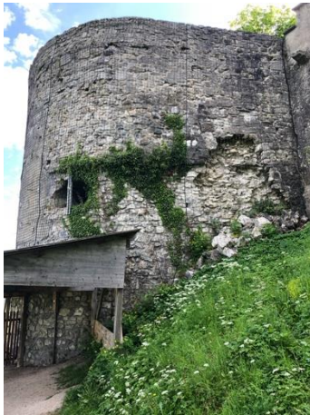
Abb. 6 Rundturm – Schäden vom 6. März 2012
