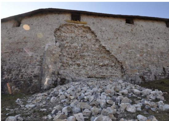
Abb. 3 Nördlicher Teil der Mauer – Schäden vom 6. März 2012
